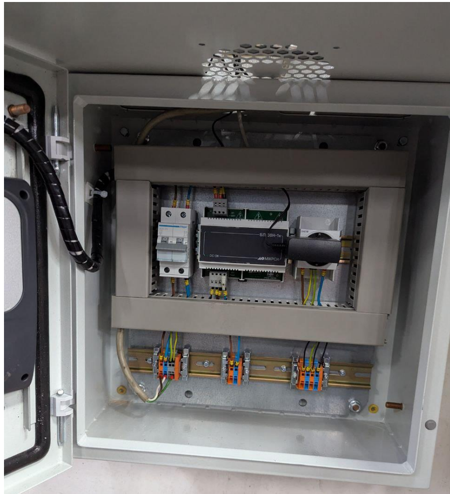
Рисунок 3.18 – внутрішній вигляд щита в приміщеннях
