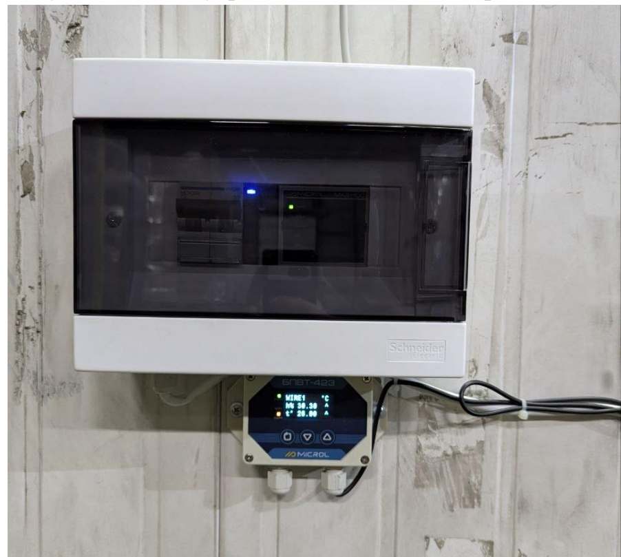
Рисунок 3.19 – внутрішній вигляд щита в приміщеннях
